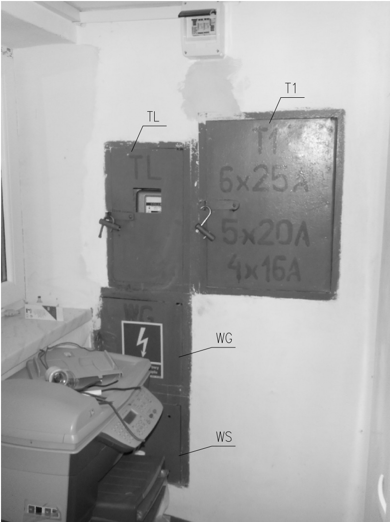
Widok wyłącznika WS, Wyłącznika głównego pożarowego WG, tablicy pomiarowej TL i rozdzielnic T1.
